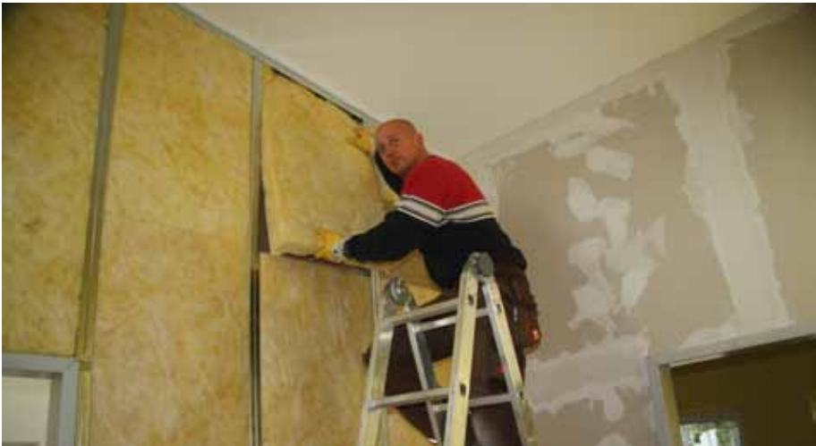
Durch Trennwände entstehen neue, kleine Räume. Die werden besonders gut schallisoliert, weil die ganz kleinen Kinder hier demnächst auch schlafen sollen.
